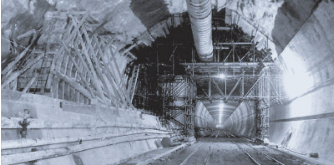
Der 10. April 1965 war, wie die Schweizerische Polierzeitung zu berichten wusste, für alle Bauleute ein interessanter und einschneidender Tag: Durchstich des San-Bernardino-Tunnels.
